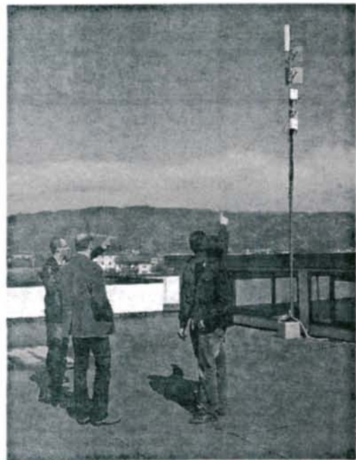
Un'antenna per la tecnologia wireless installata sul tetto della società a Ponte Buggianese
